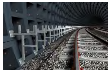
Stavební vybavení v tunelech
