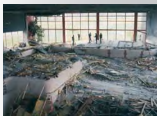
V roce 1985 povolil zavěšený betonový strop krytý plovárnou v Usteru, ve Švýcarsku. Stropní spojovací prvky z nerezavějící oceli nevykazovaly žádné vnější známky poškození, ale uvnitř byly v některých případech zcela zničeny v důsledku popraskání způsobeného korozi napětím
